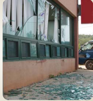
폭발에 의한 유리창 파손
