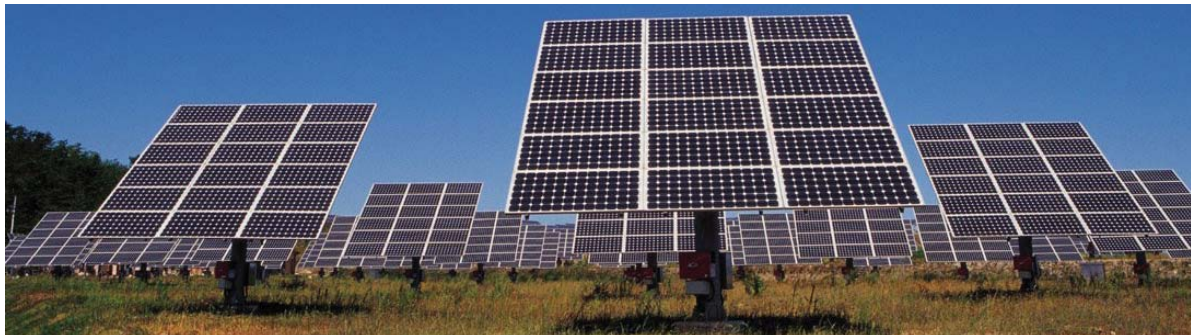
▲ 그림 95 _ 전라남도 신안 동양 태양광 발전소 세계 최대의 추적식 태양광 발전소로 고정식 집열판을 이용할 때보다 효율이 높다.
