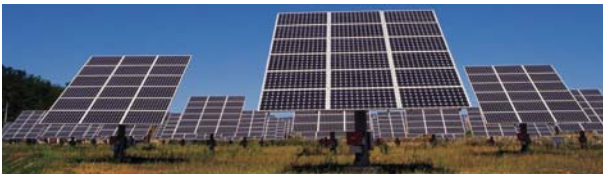
▲ 그림 95 _ 전라남도 신안 태양광 발전소 세계 최대의 추적식 태양광 발전소로 고정식 집열판을 이용할 때보다 효율이 높다.
